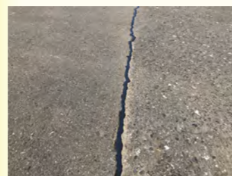
クラック補修
